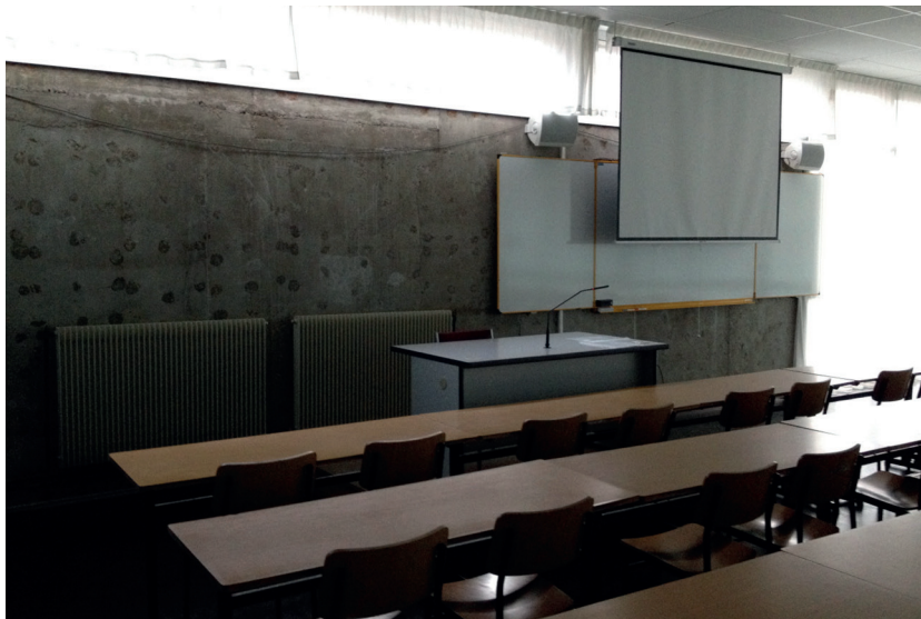
Faculté de droit de Nantes : pas d'isolation, mais pas de chauffage non plus. http://universiteenuines.tumblr.com
